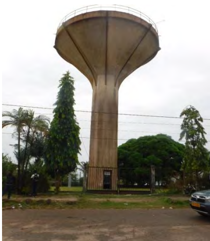
Photo 11: Château d'eau d'Alénakiri, TEREA Avril 2011.
