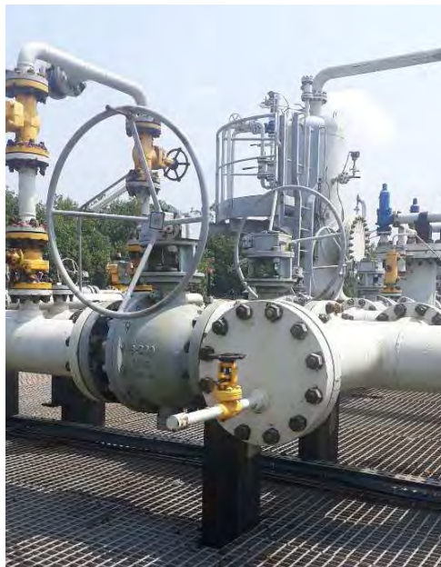
Photo 5 : Station de gaz Perenco, point de raccordement du gazoduc
