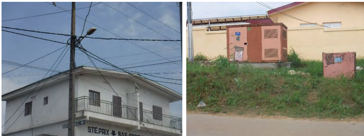
Photo 10 : Présence de lignes électriques et de transformateurs, TEREA Avril 2011
