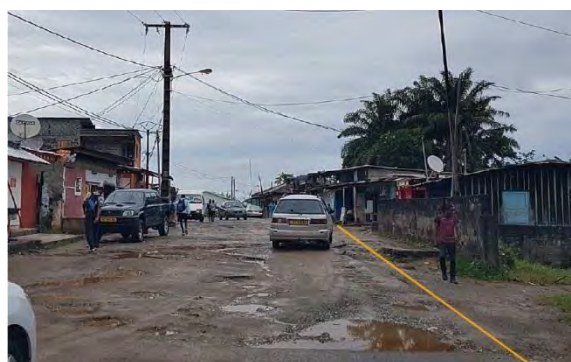
Photo 4 : vue de la zone 3 où l'enrobé est très détérioré (zone 3)
