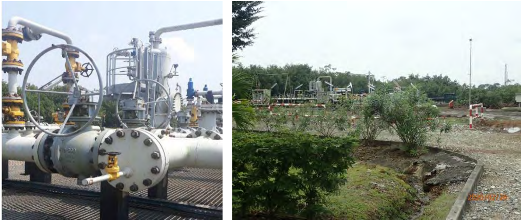
Photo 1 : Station de détente de gaz de Perenco
